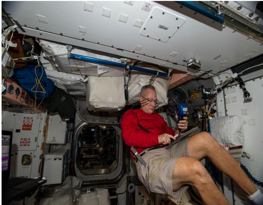
FIGURA 30 MONITOREO EL FLUJO DE AIRE E INSPECCIÓN DE LOS COMPONENTES. FUENTE EL ASTRONAUTA DE LA NASA Y EL INGENIERO DE VUELO DE LA EXPEDICIÓN 63.
